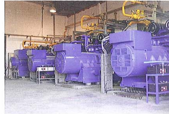
Tres motores MWM TCG 2020 V12 de nueva instalación, junto con el motor antiguo MWM TCG 2020 V16 K
