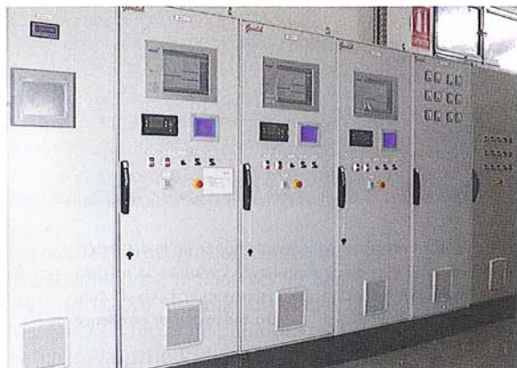
Frente del armario de control, protección y sincronismo, dotado de seis cuerpos y desde donde se puede controlar a través de tres pantallas TEM el estado de cada motor.
