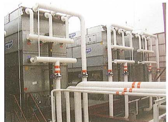
Enfriadores de alta eficiencia. CC Los Arcos
