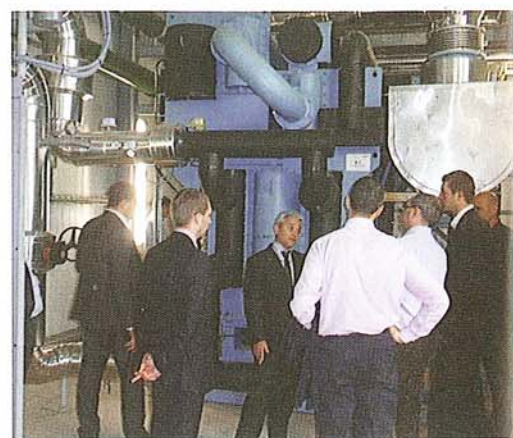
Central de Trigeneración en CC Parquesur
