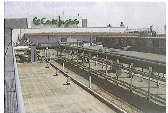
Distribución de calor y frío en CC Parquesur
