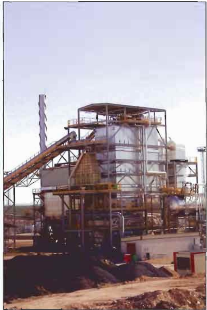
Caldera de biomasa
