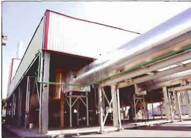
Los secaderos utilizan parte del calor residual de la cogeneración
