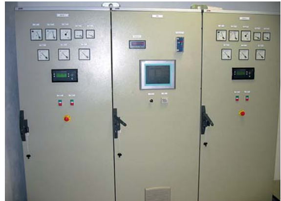
Cuadro de control, protección y sincronismo 2 grupos
